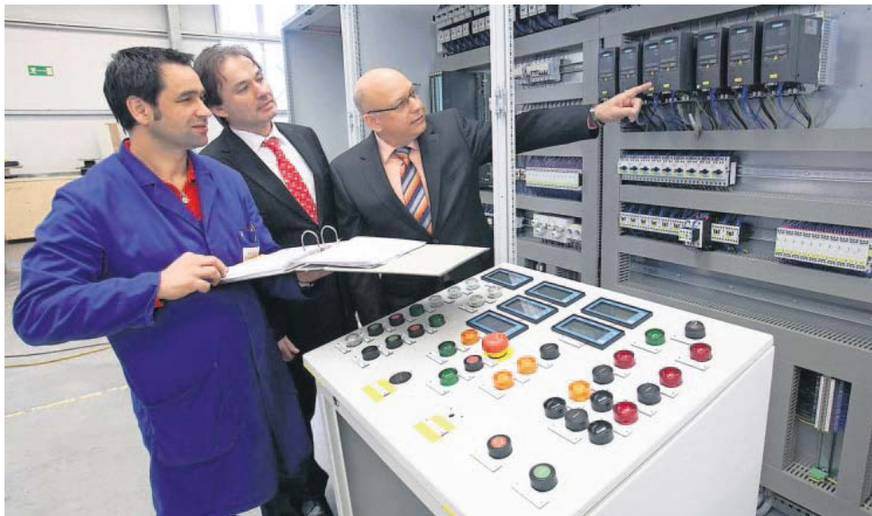
Was hier entsteht, könnte bald bei der BASF, in einer Getreidebrennerei oder einer Biodiesel-Anlage die Prozesse regeln: Werkstattleiter Hubert Thanei zeigt den beiden Geschäftsführern Bernd Stadler und Eugen Schaaf (von links) die Schaltanlagen.
